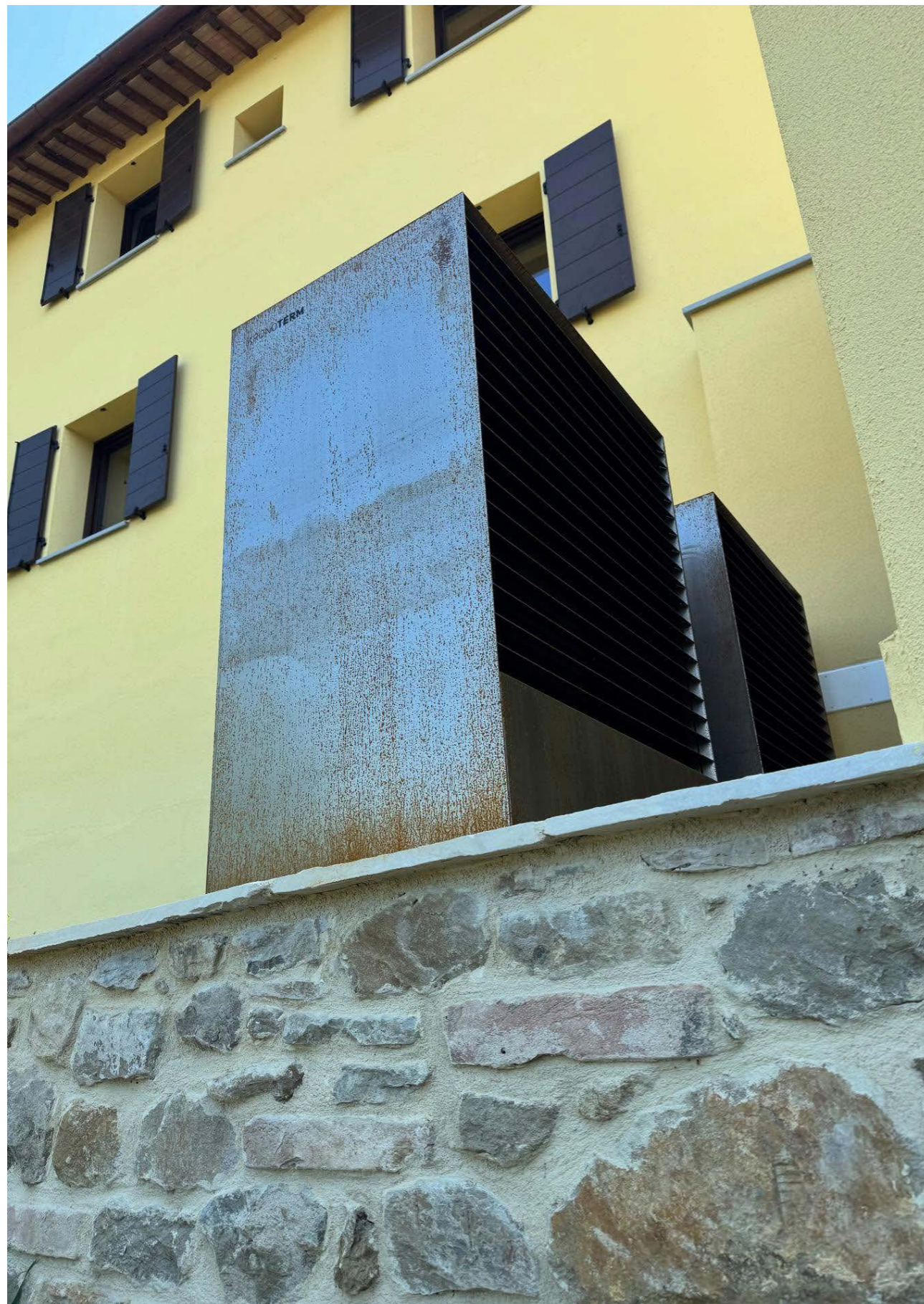
Pompa di calore esterna
