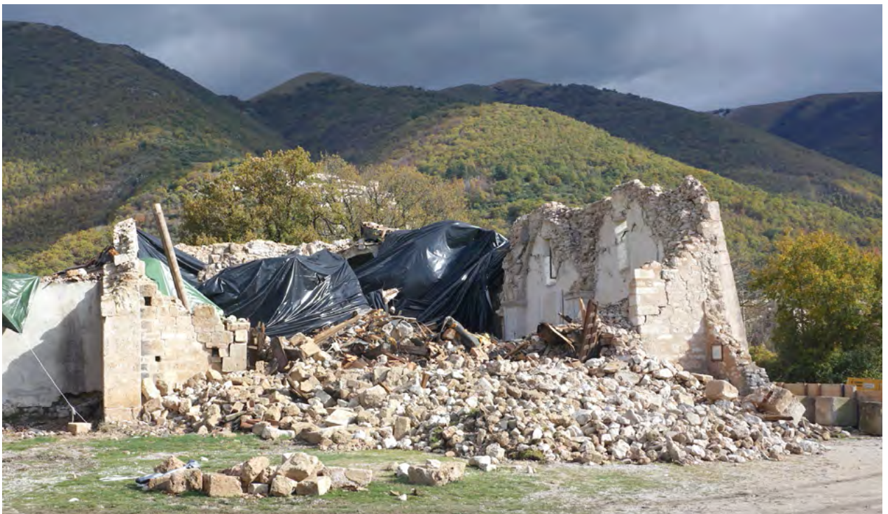
Chiesa di San Salvatore a Campi, completamente distrutta dal sisma del 2016
